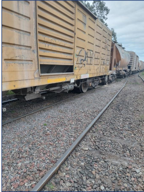
Figura 3. Vista general del aparato de vía afectado por el suceso. Fuente: JST, 2024
