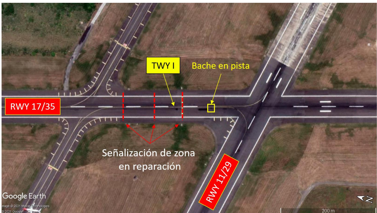
Figura 14. Ubicación del bache y señalización correspondiente. Fuente: Elaboración propia
