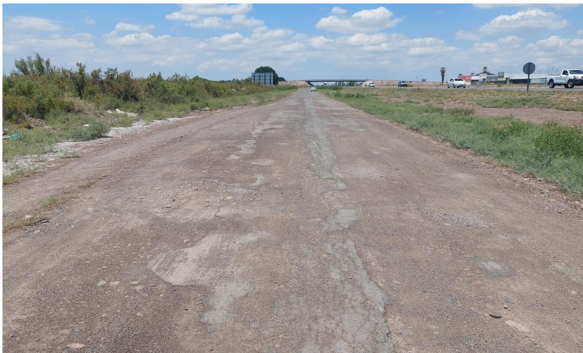
Figura 6. Vista general de la colectoras Lateral Norte hacia el este (sentido contrario al de marcha en el accidente). Fuente: JST, 2024
