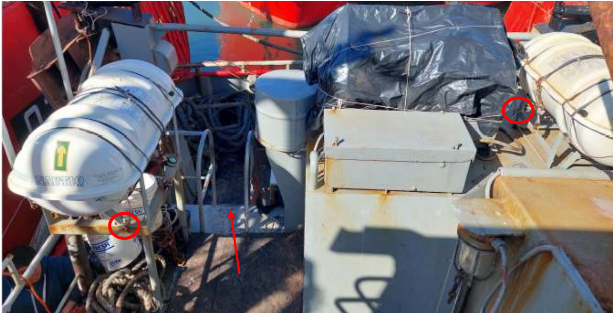
Figura 17. Superestructura de popa. Se observa que las bozas de ambas balsas salvavidas están firme a partes estructurales del buque en lugar de estar conectadas a los eslabones débiles del sistema de zafa. Además, se remarca con una flecha el acceso a este sector por la escalera vertical de popa.
