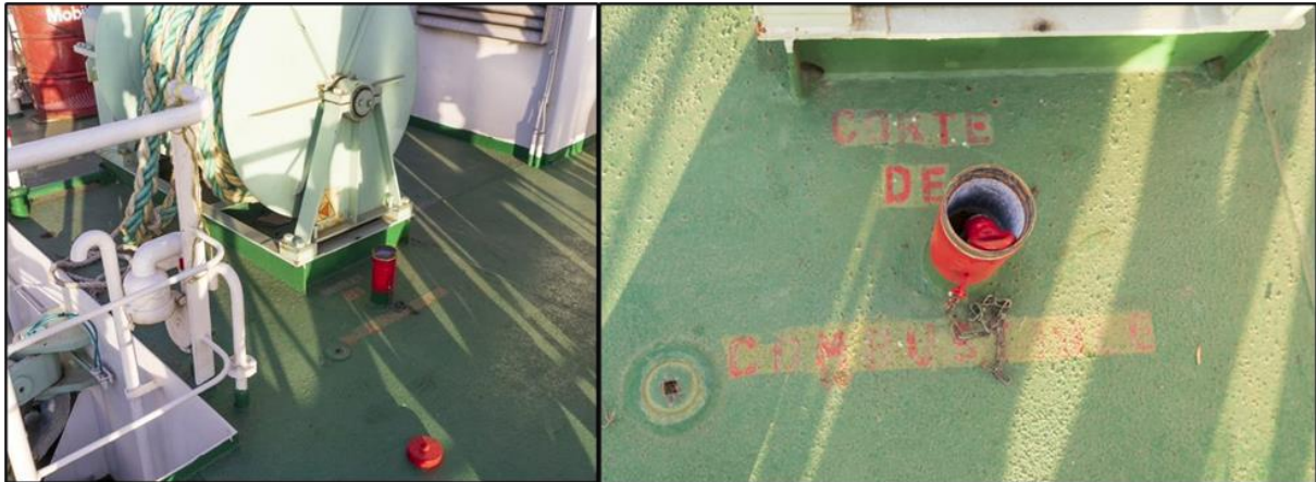
Figura 10. Corte de combustible a distancia ubicado en el sector de popa de la cubierta superior. Se observó sin la tapa y con la manija hacia arriba con signos que el cierre de la válvula fue accionado a distancia por medio del tensado del cable
