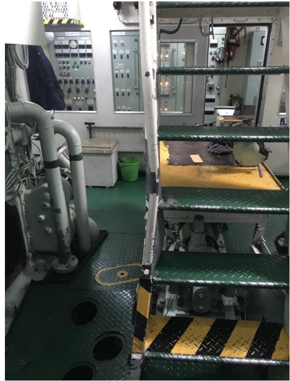
Daño en escalera de acceso a sala de máquinas
