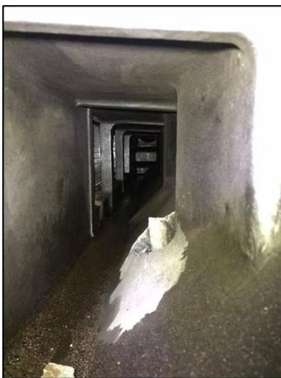
Figura 14. Interior del colector de aire de admisión. Se observa que estaba limpio, sin evidentes rastros de aceite
