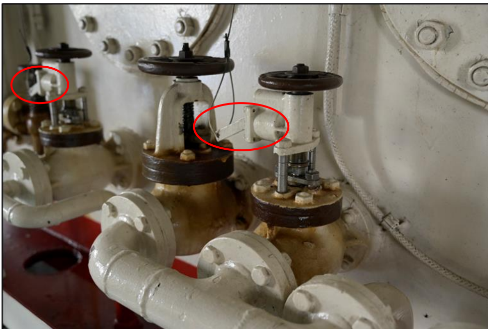
Figura 11. Válvulas correspondientes al tanque diario y al tanque de reposo de combustible. Los círculos rojos en las válvulas con accionamiento a distancia, señalan las palancas que van conectadas al cable de accionamiento remoto
