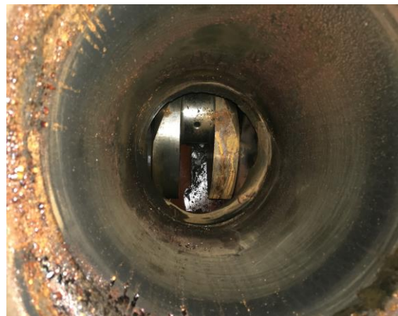
Daño en camisa
