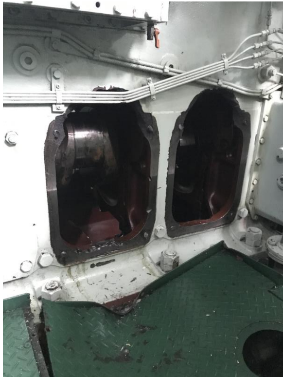
Daños en el block y chazas del piso
