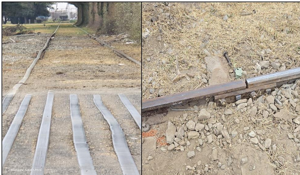
Figura 13. Izquierda: estado de la vía hacia la estación Venado Tuerto. Derecha: estado de junta eclisada. Fuente: JST, 2024
