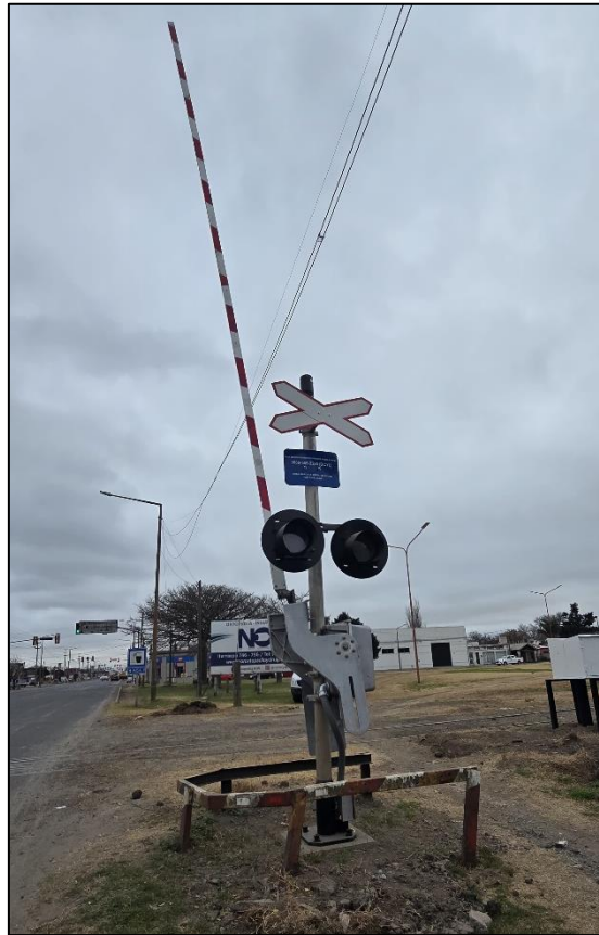
Figura 12. Sistema de señalización nuevo. Fuente: JST, 2024
