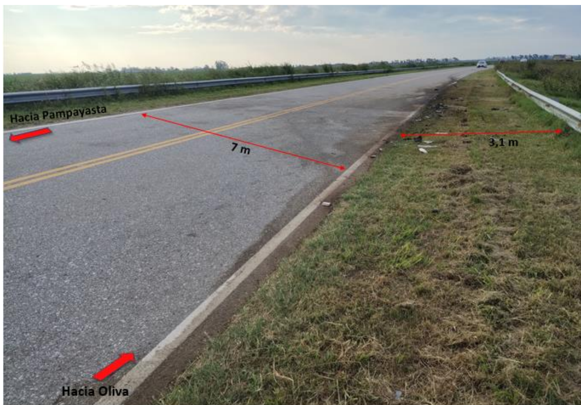
Figura 3. La vía y sus características. Fotografía tomada desde la banquina derecha, carril que se dirige hacia Oliva. Fuente: JST, 2024
