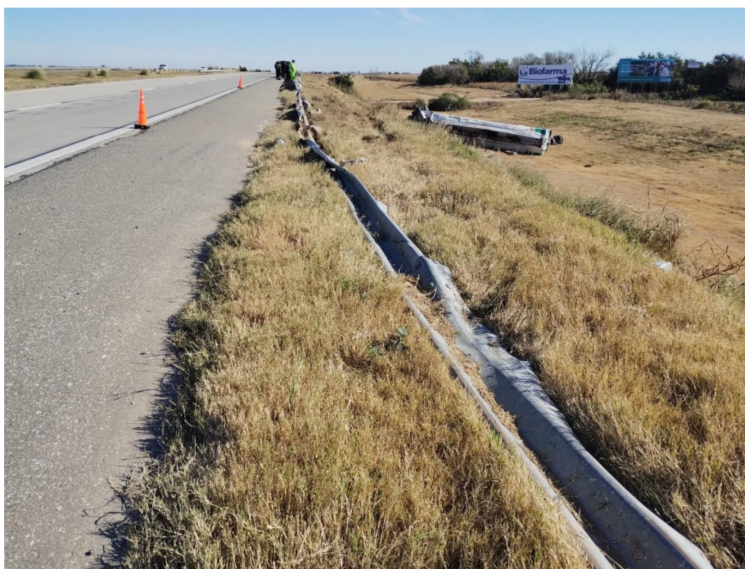
Figura 8. Daños a la infraestructura vial. Se observa la deformación y desplazamiento de la barrera de contención metálica. Fuente: JST, 2024
