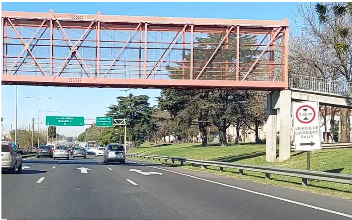
Figura 4. Señalización vertical previa al puente impactado. Fuente: JST, 2024
