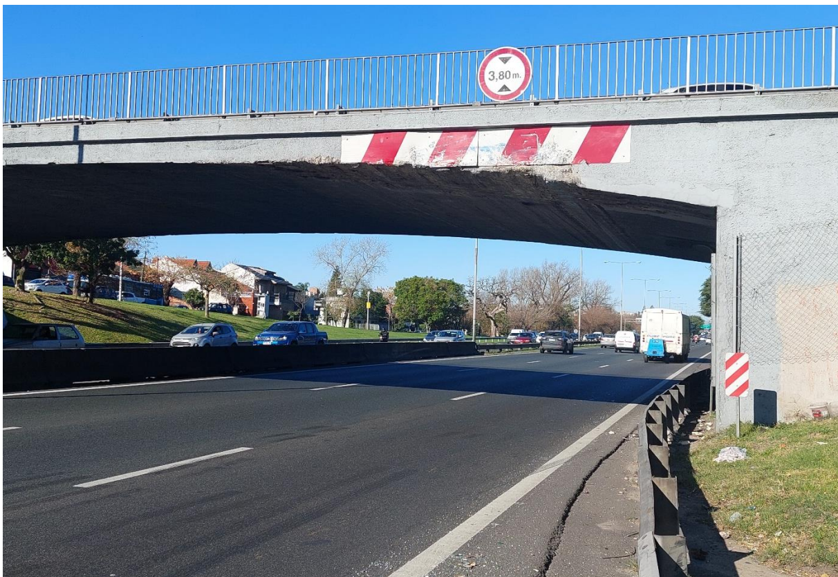
Figura 6. Señalización de altura máxima y panel de prevención sobre el puente chocado. Fuente: JST, 2024
