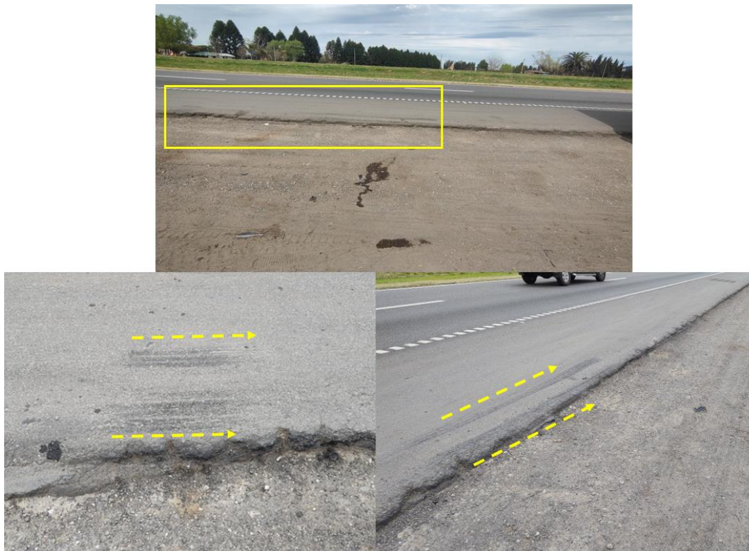
Figura 10. Huellas producidas por el arrastre del Vehículo 2. Fuente: JST, 2024
