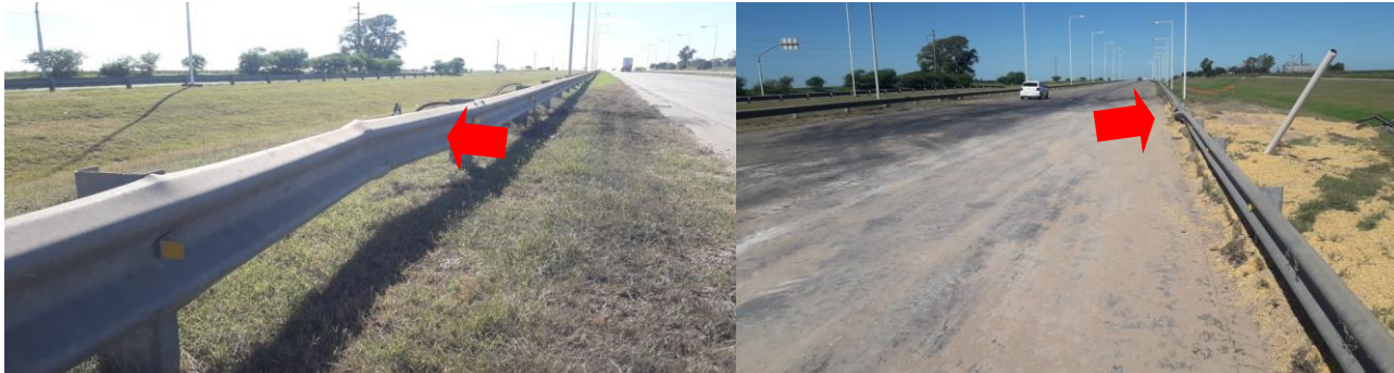
Figura 18. Daños en las barreras metálicas lado izquierdo y derecho de la vía, respectivamente. Vistas hacia el cardinal este. Fuente: JST.
