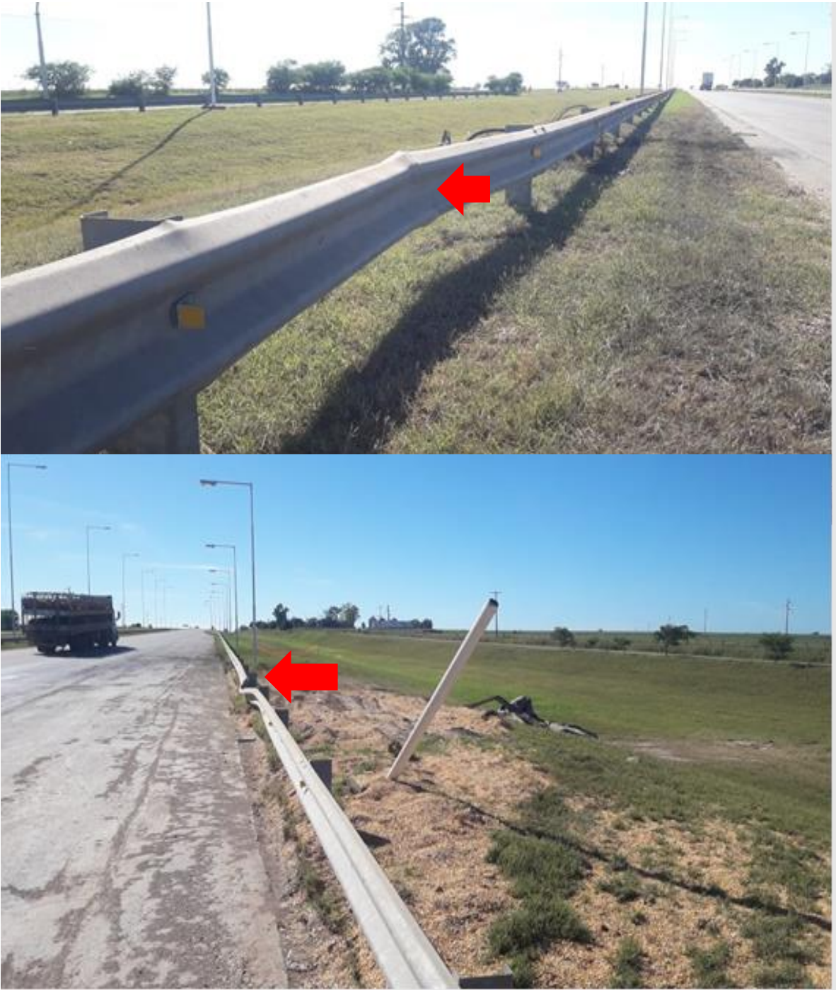
Figura 6. Daños en las barreras metálicas
