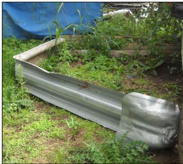
Figura 18. Fotografía de viga deformada, correspondiente al extremo terminal de la barrera de contención impactada. Fuente: JST
