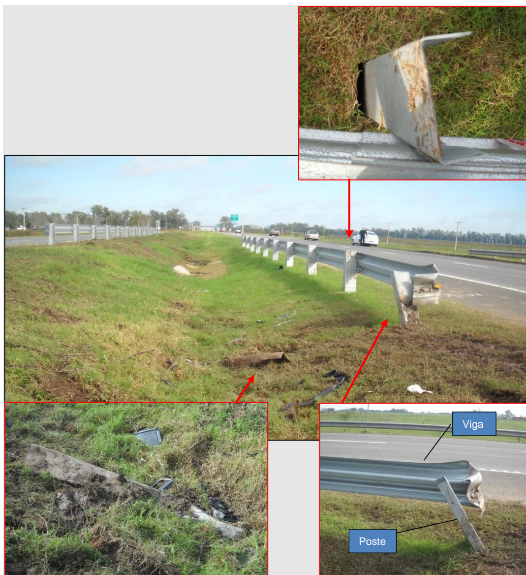
Figura 13. Fotografías de la zona de impacto y detalles de la barrera de contención impactada y daños directos e indirectos en postes. Fuente: JST
