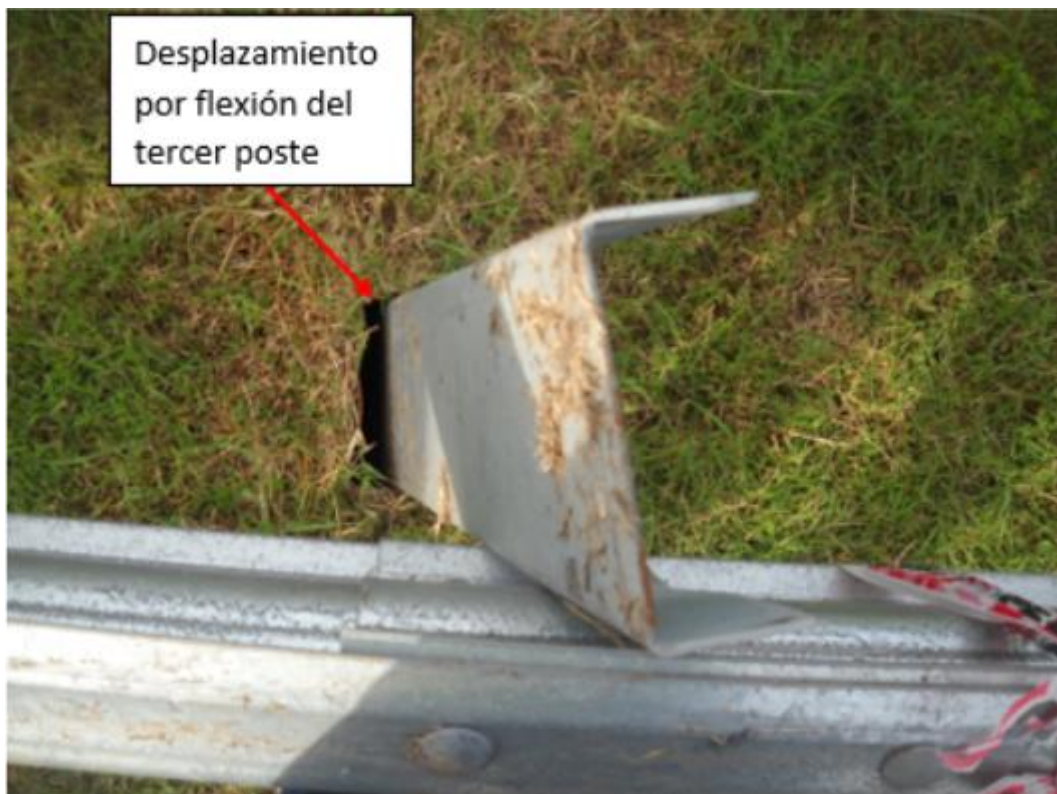
Figura 17. Daño en el tercer poste. Fuente: JST, 2021
