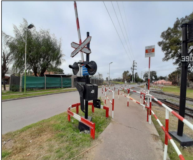
Figura 28. Cruz de San Andrés vertical sobre el sistema de barreras automáticas
