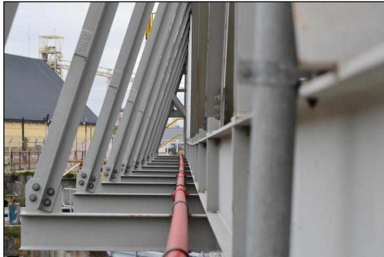
Figura 7. Flecha en el 1er tramo de CT1 descargado. Fuente. JST, septiembre de 2021
