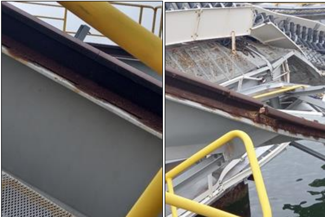
Figura 10. Fisuras y fractura del riel. Fuente. JS, septiembre de 2021
