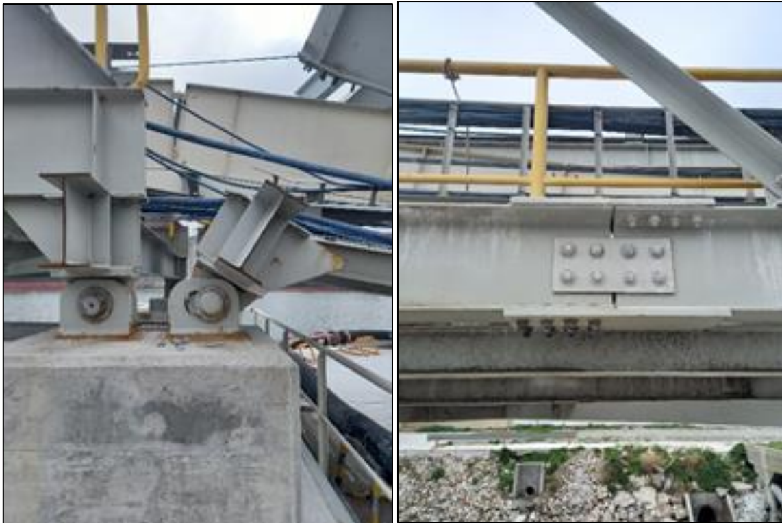
Figura 9. Apoyo de la galería (izquierda) / Unión de vigas de galería (derecha). Fuente: JST, septiembre de 2021
