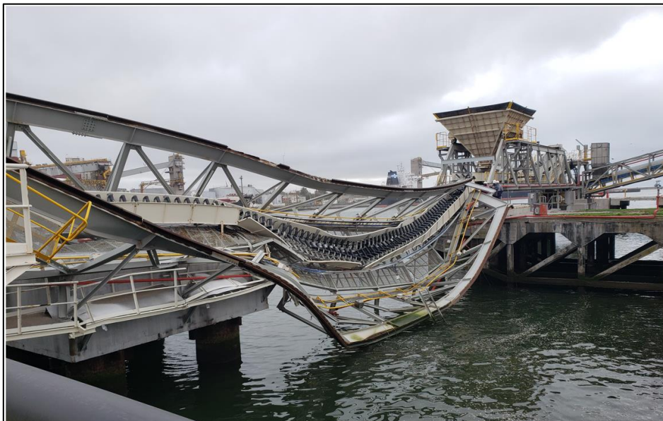
Figura 1. Galería colapsada. Fuente. JST, septiembre de 2021
