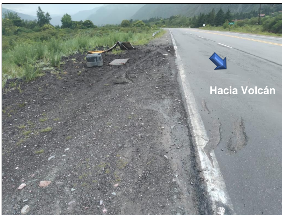
Figura 4. Características del costado este de la calzada, sector donde se produjo el vuelco del camión, y de su punto de inmovilidad final. Fuente: JST, 2021.
