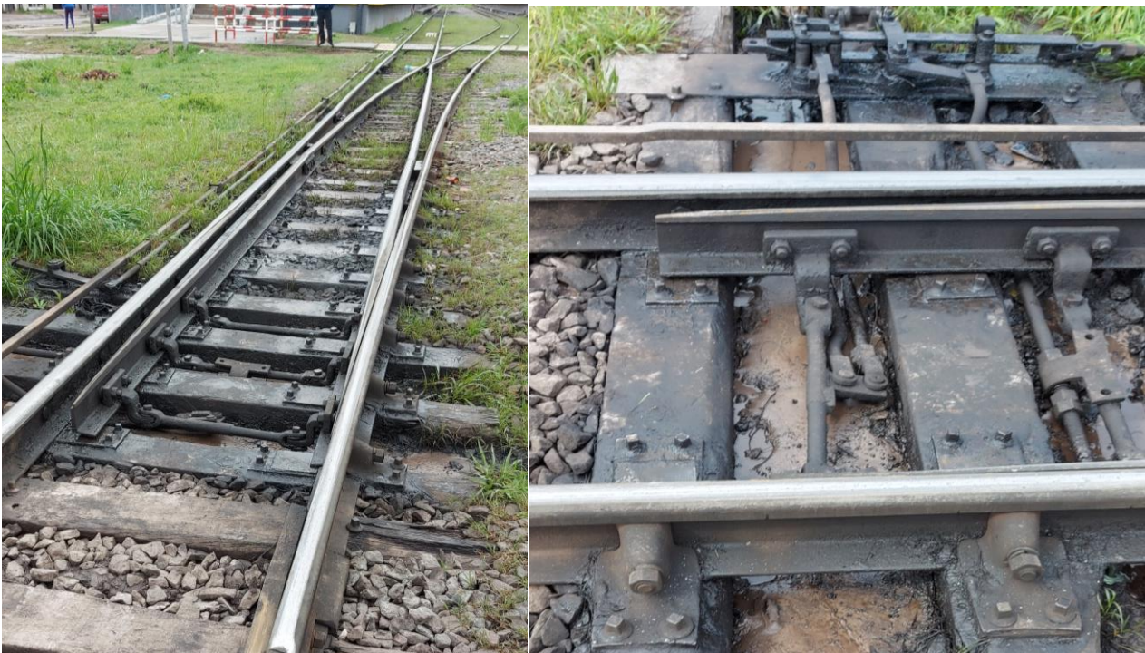
Figura 8. Vista general de las agujas de ADV N°1 (derecha) y estado de puntas de aguja de ADV N°1 (izquierda). Fuente: Archivo JST
