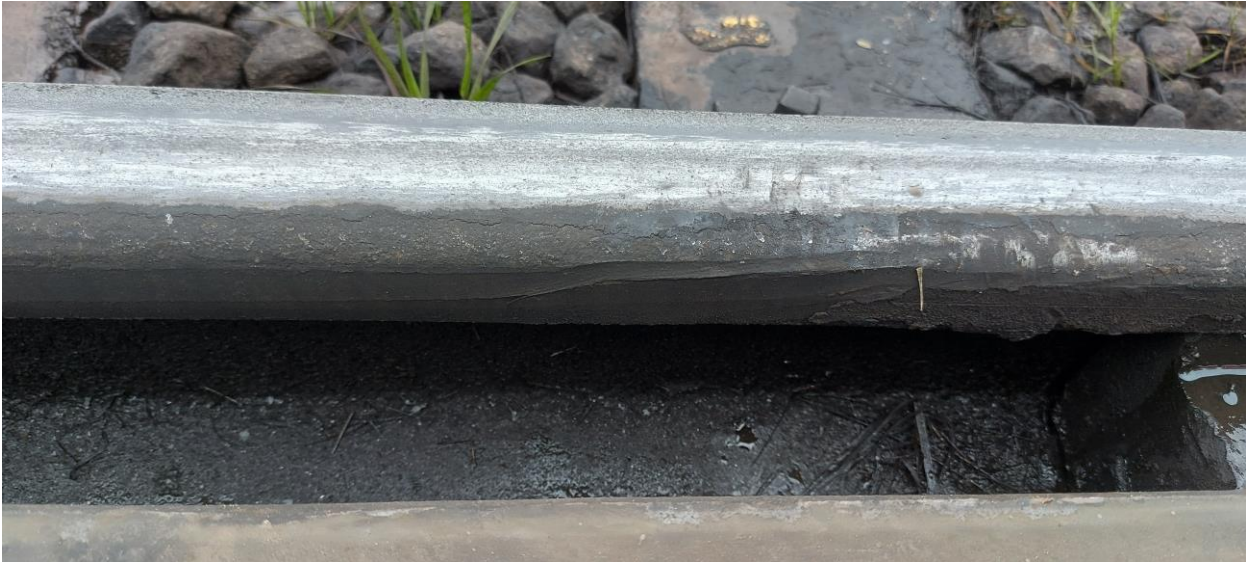
Figura 10. Marcas de montaje de la pestaña derecha del eje 1 del coche involucrado sobre el talón de aguja derecha. Fuente: Archivo JST
