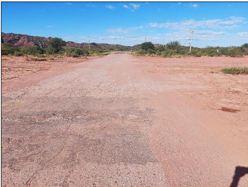
Figura 13. Vista panorámica de tramo de la ruta y cauce. Se observa la calzada deteriorada con gran cantidad de tierra suelta y límites externos difícilmente visibles. Fuente: JST, 2022
