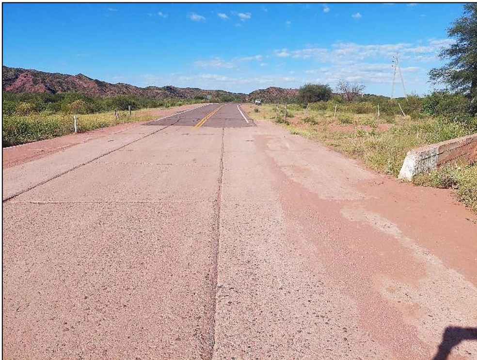
Figura 15. Vista panorámica del tramo final del cruce entre la ruta y el cauce. Se observa diferencia de materiales de la calzada y elevación del terreno. Fuente: JST, 2022
