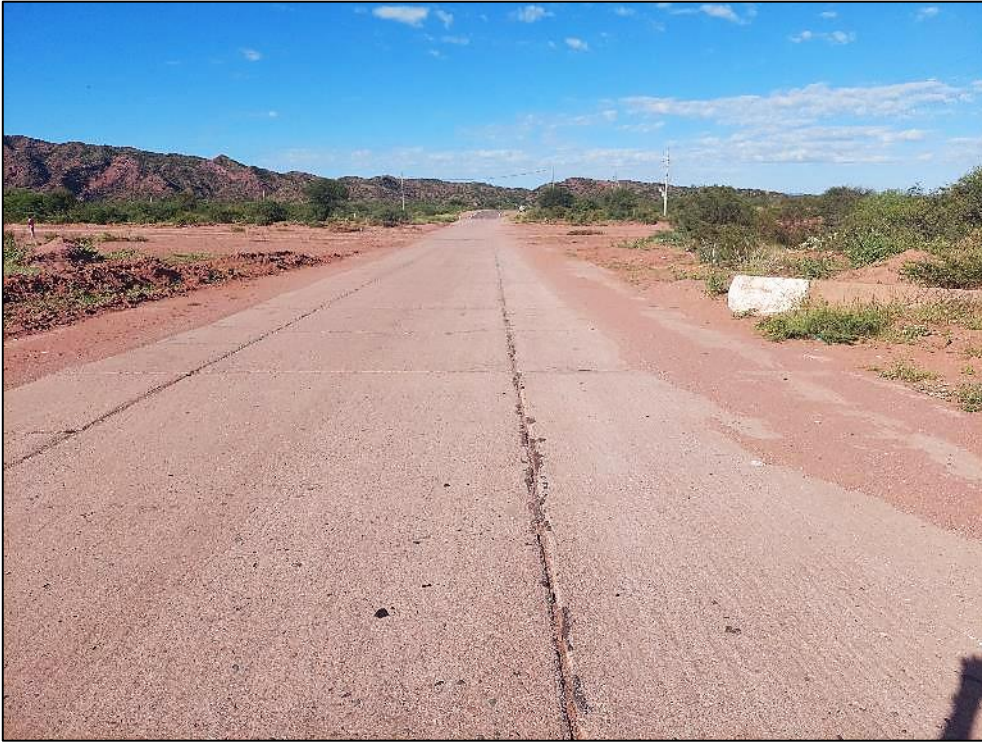
Figura 10. Vista panorámica del Vehículo 1. Tramo inicial del cruce de la ruta con el cauce. Se observa otro material sobre la calzada (en relación con el resto de la ruta), aquí hormigón. Nótese la tierra sobre la calzada y el estado de las juntas. Fuente: JST, 2022
