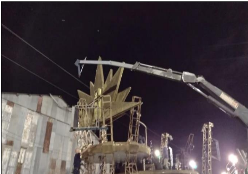
Figura 16. Secuencia del desprendimiento de la guindola
