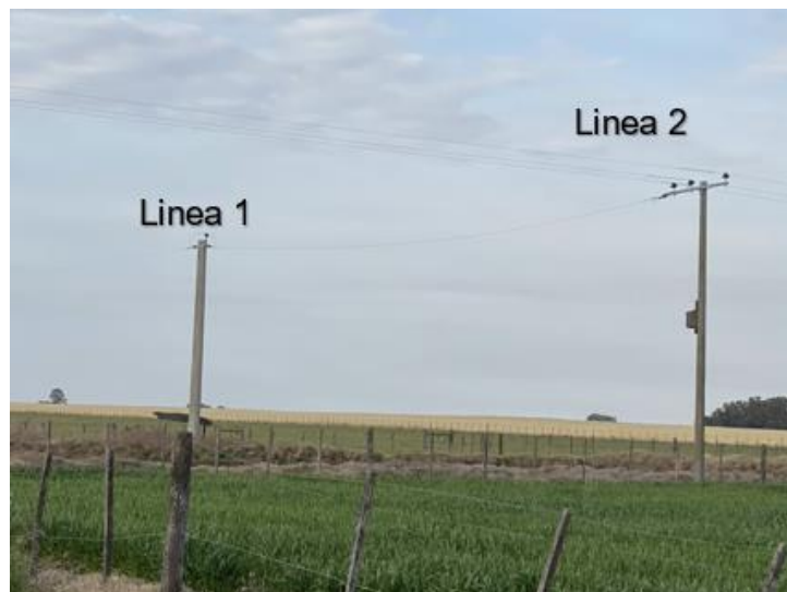
Figura 2. Vista de ambos tendidos eléctricos
