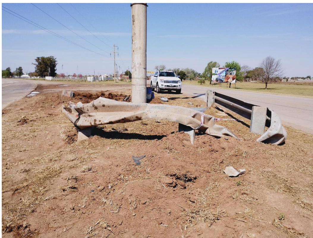
Figura 4. Deformación de barrera de contención lateral a causa del impacto. Fuente: JST, 2022
