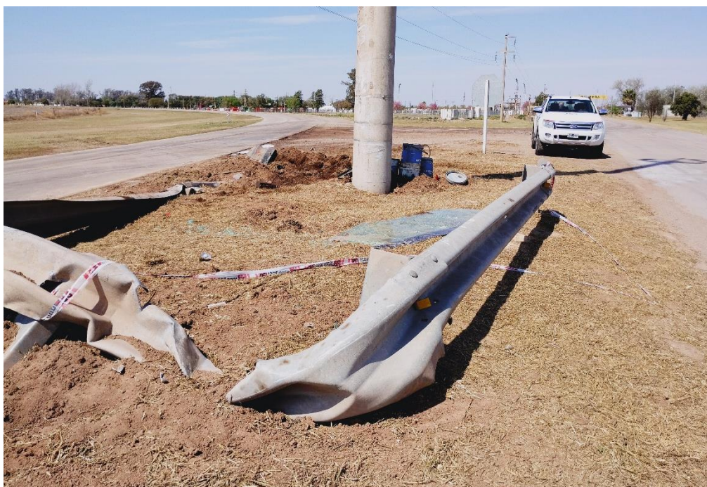
Figura 13. Daños sobre la barrera de contención metálica poscolisión. Fuente: JST, 2022
