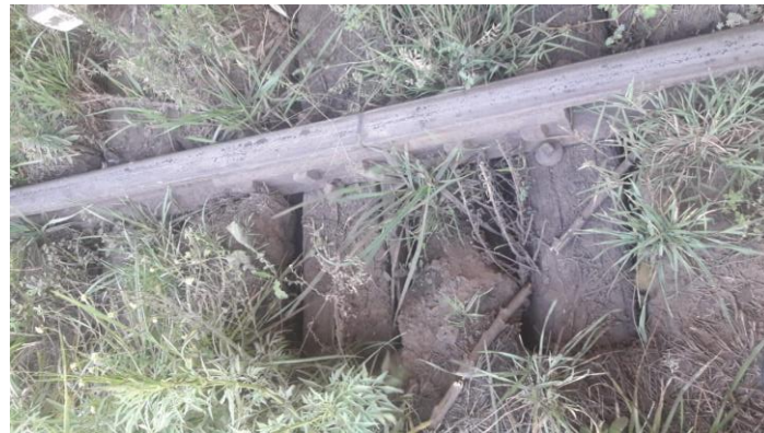
Figura 4. Vía sin soporte de la plataforma producto de la licuefacción del balasto de tierra. Fuente: Investigadores JST
