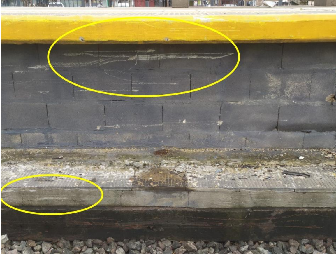
Figura 5. Daños en el andén en sentido a la estación Tapiales. Fuente: investigadores JST, 2021
