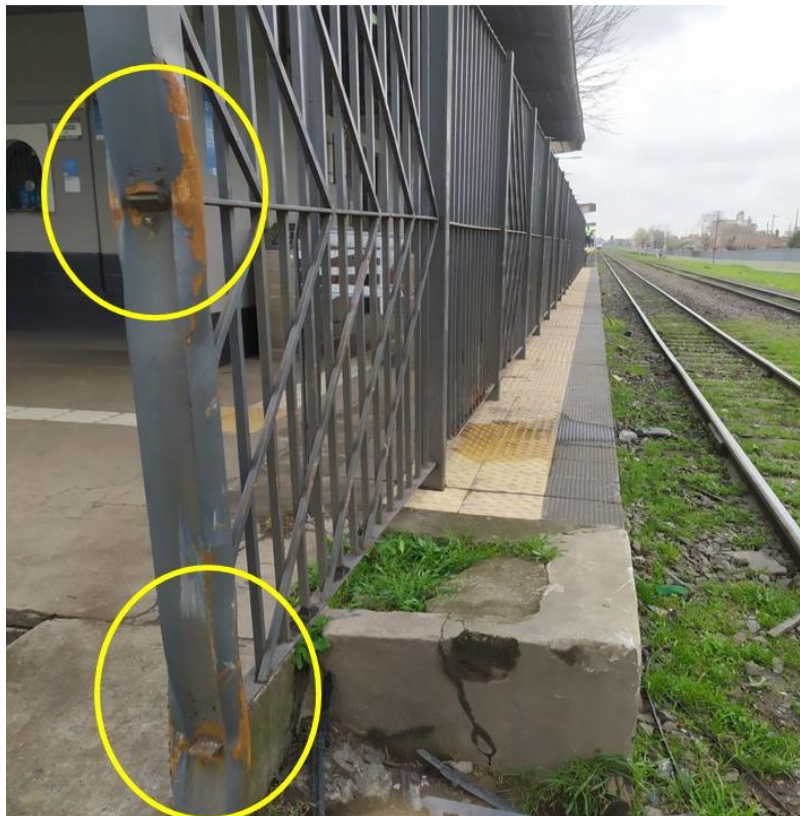
Figura 4. Daños en la reja perimetral ubicada antes del andén, en sentido a la estación Tapiales. Fuente: investigadores JST, 2021
