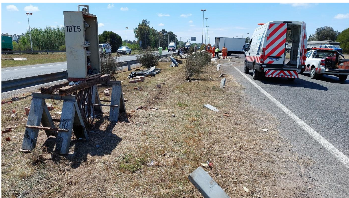
Figura 13. Daños en el regulador de tensión impactado por el camión con semirremolque. Fuente JST, 2022
