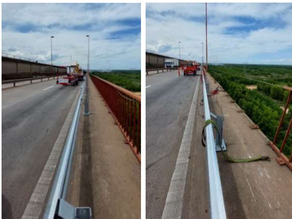
Figura 17. Reemplazo de la barrera de contención que impactó el camión con acoplado. Fuente: JST, 2022
