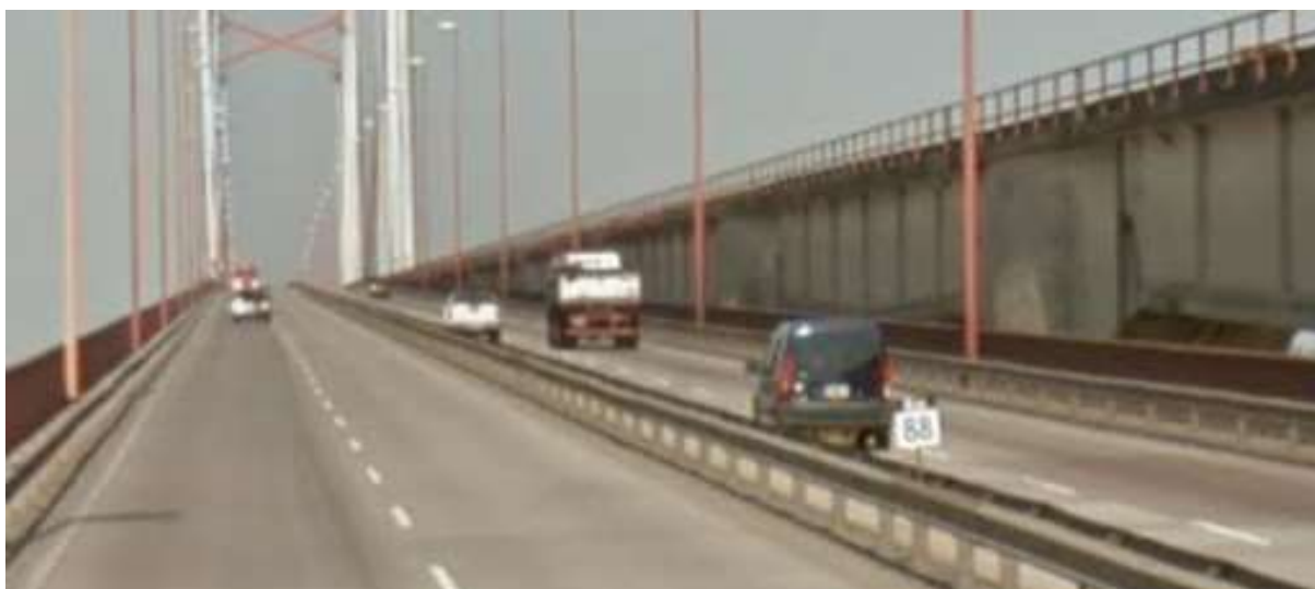
Figura 5. Indicador del kilómetro 88 129 m hacia Ceibas desde el inicio de las deformaciones en la barrera de contención. Fuente: JST, 2022
