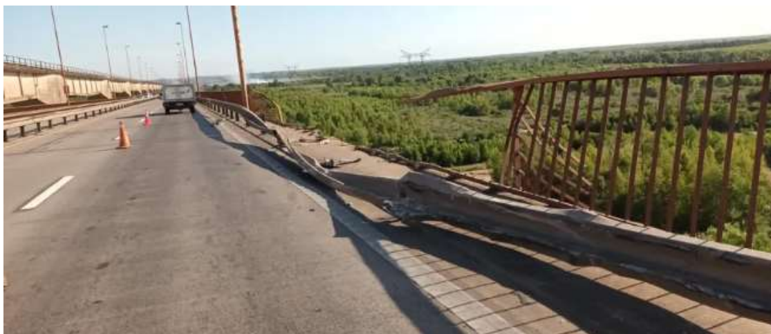
Figura 16. Aplastamiento de la barrera de contención y desprendimiento de la baranda peatonal que evidencian la zona de despeñamiento. Fuente: Infocielo , 2022
