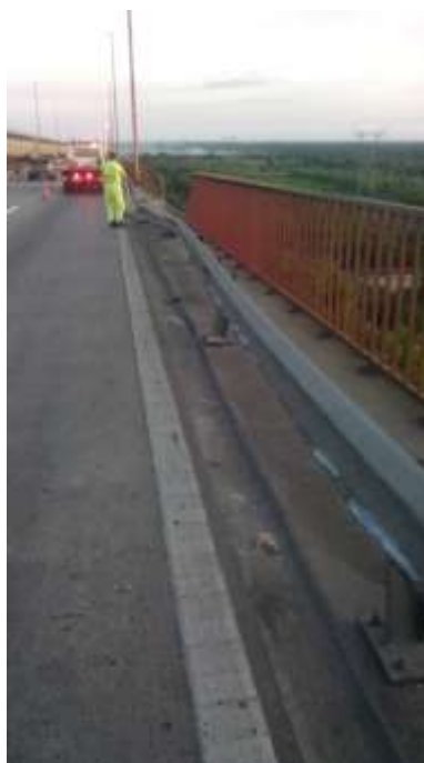
Figura 15. Sector donde el camión con acoplado impactó con la barrera de contención. Fuente: La Pirámide , 2022
