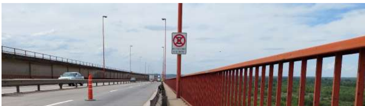
Figura 4. Señalización vertical de “NO ESTACIONAR NI DETENERSE” 160 m hacia Zárate desde el inicio de las deformaciones en la barrera de contención. Fuente: JST, 2022
