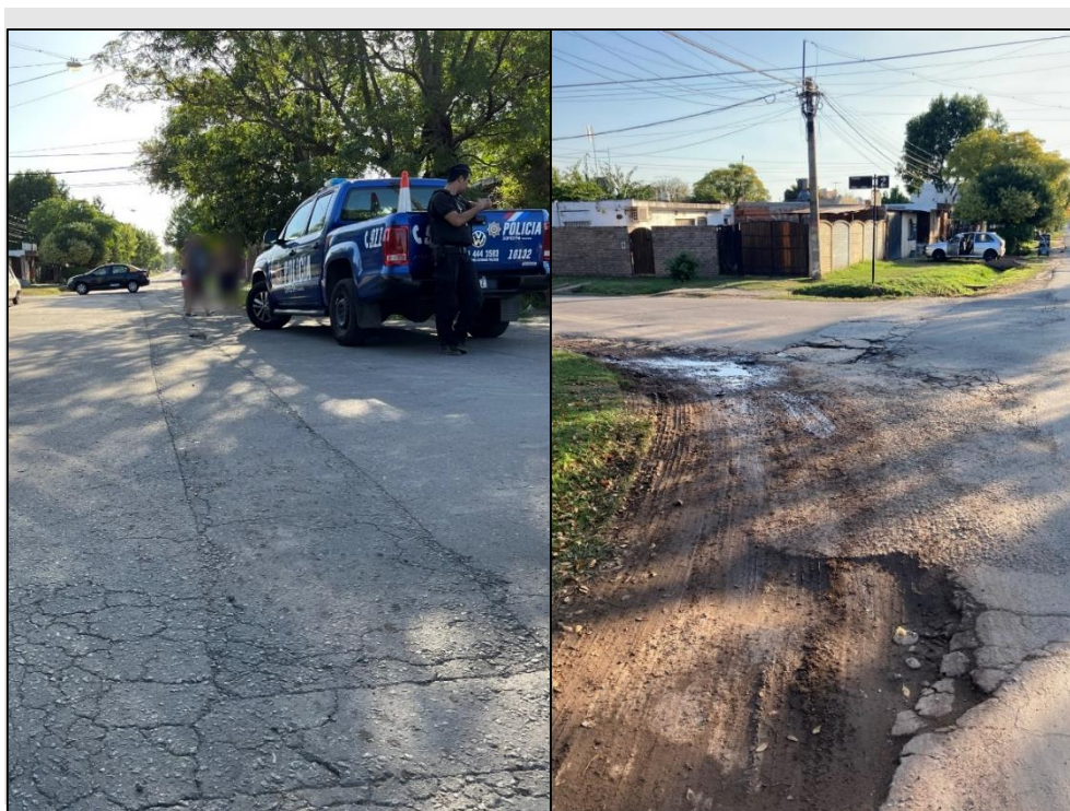
Figura 8. Visualización de la calzada vehicular, entre calle Polledo y el cruce de vías vista hacia cardinal este, con parches, fisuras y descascaramientos, tierra y vegetación. Fuente: JST, 2023
