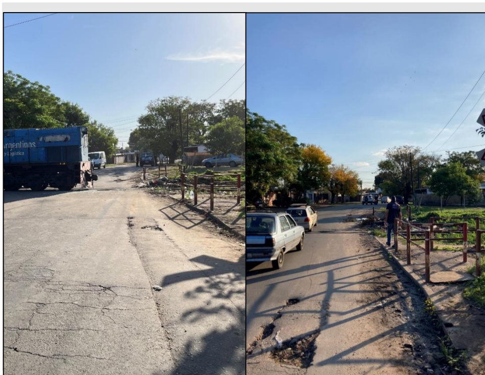
Figura 7. Visualización de la calzada vehicular desde calle Blomberg con parches, fisuras y descascaramientos. Fuente: JST, 2023
