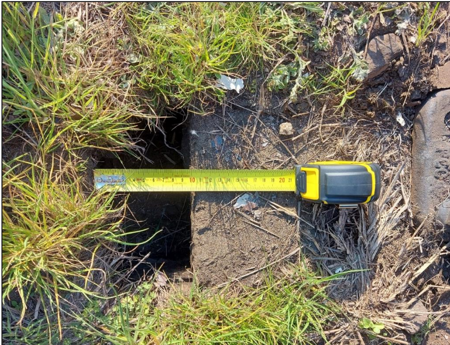
Figura 8. Corrimiento lateral de la superestructura de la vía giratoria 1 Fuente: JST, 2021
