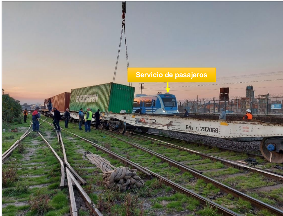
Figura 7. Imagen de las tareas de encarrilamiento de los vagones afectados por el suceso, donde se observa la reanudación del servicio de pasajeros por la vía principal del ramal J.L. Suárez-Retiro.
