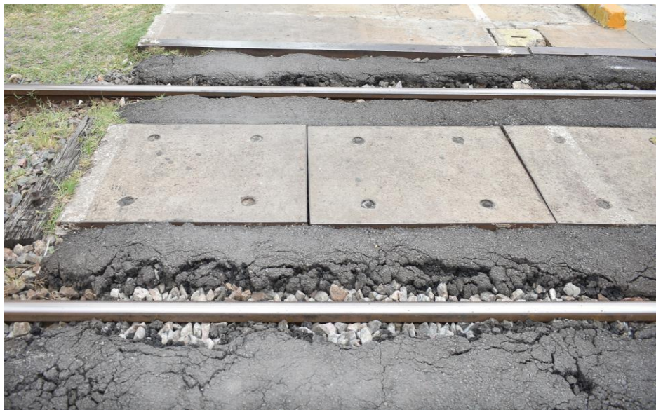
Figura 10-11 – El paso peatonal presenta roturas.
