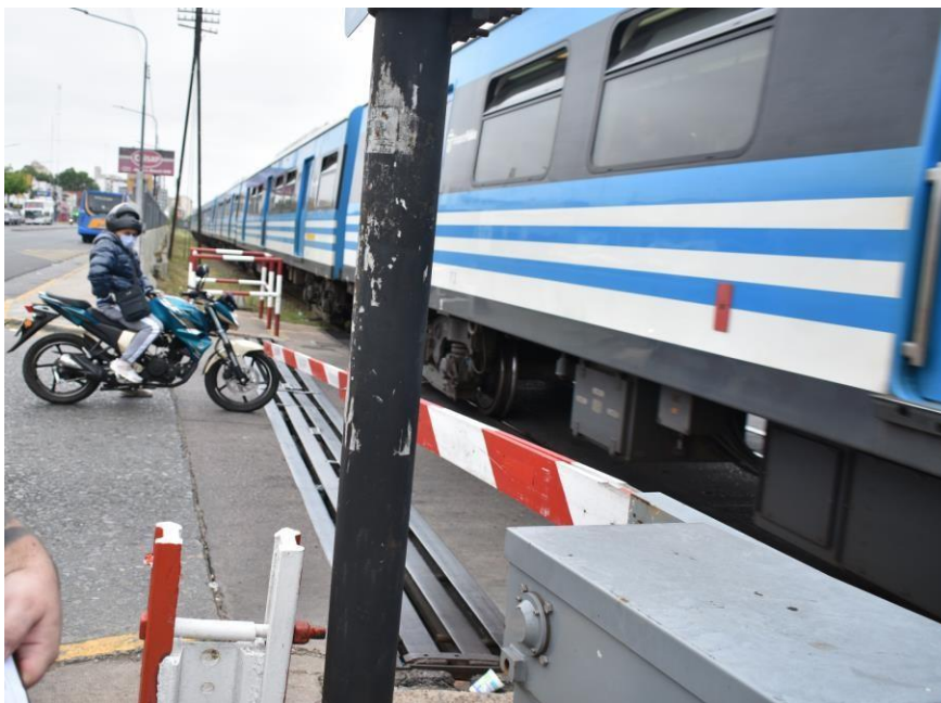
Figura 5- El brazo de barrera ascendente (Av. Rivadavia), posee una curvatura en el eje transversal respecto a la infraestructura ferroviaria, que se desvía en su extensión aproximadamente 40 cm hacia el lado de la citada avenida.
