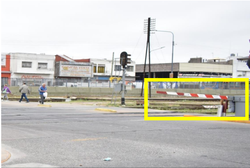
Figura 4- El brazo de barrera descendente (Av. Maipú), presenta una rotura (ya verificada en el relevamiento realizado el 01/11/2021).
