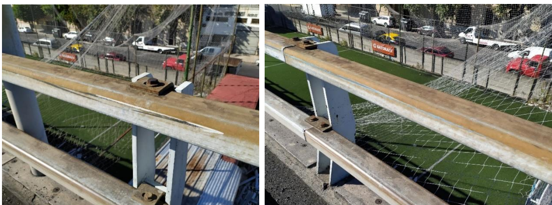
Figura 15. Transferencia de pintura azul y negra sobre las barreras de contención junto al margen derecho. Fuente: JST, 2023
