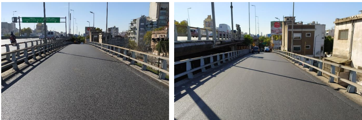
Figura 3. Características de la rampa de egreso hacia la calle Colombres. Fuente: JST, 2023
