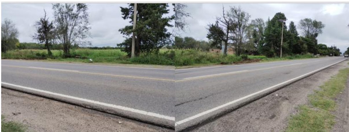
Figura 17. Estado de conservación de la calzada en el tramo donde ocurrió el suceso. Fuente: JST, 2023
