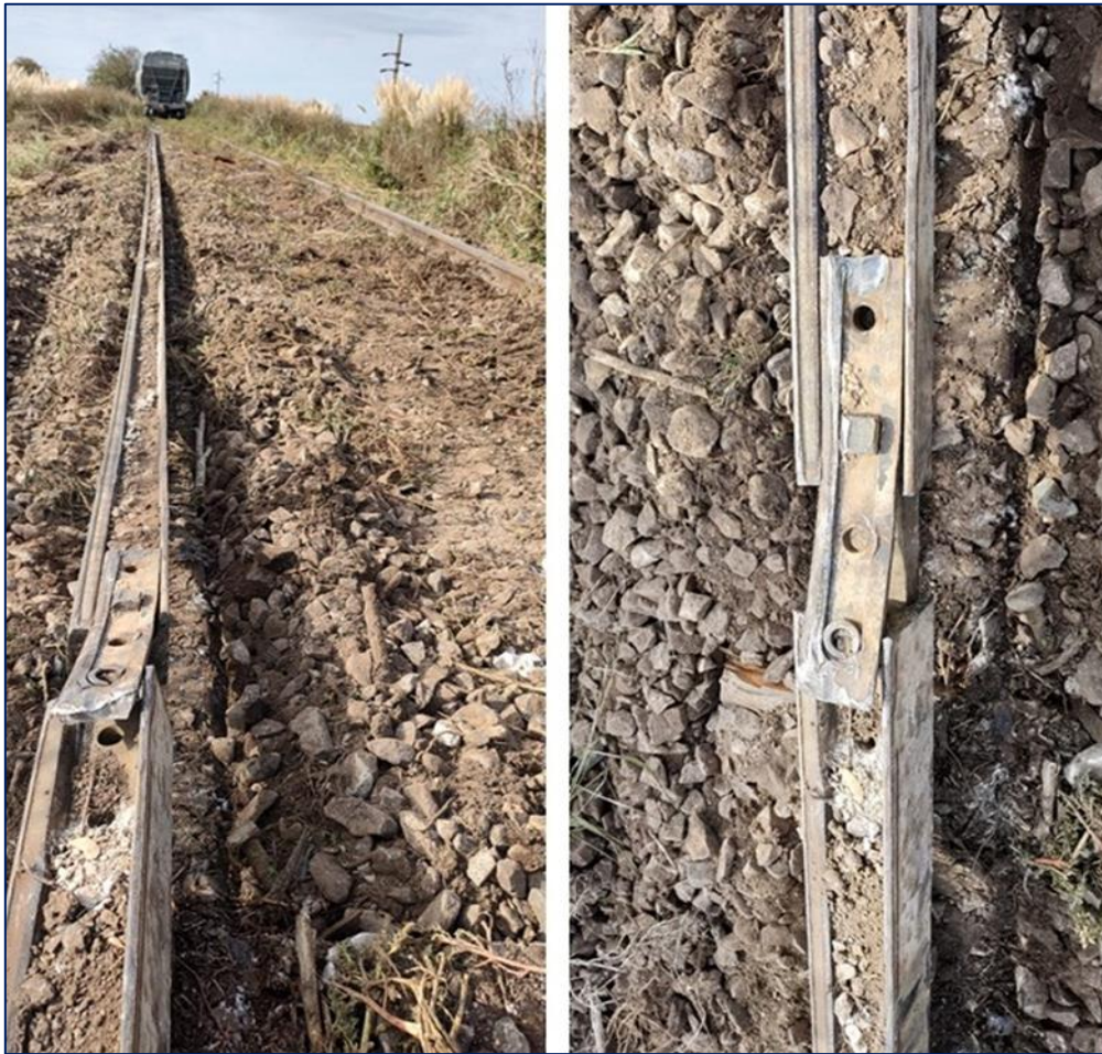
Figura 3. Daños generales en la superestructura (izquierda) y eclisa con falta de bulones (derecha).
