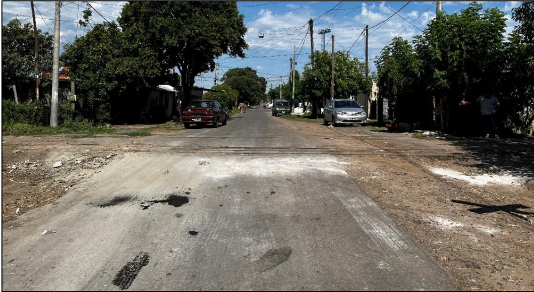
Figura 4. Estado actual de la calzada vehicular. Fuente: JST, 2023
